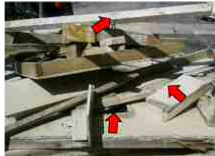
(回収時、栈木が外され、ボードが切断されていた例)
