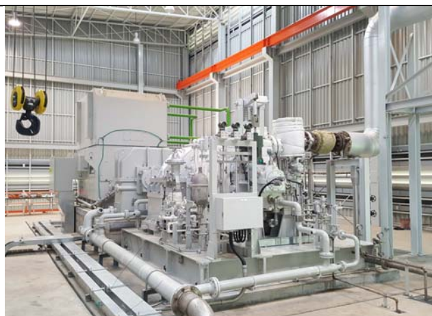
蒸気タービン発電設備(イメージ)
