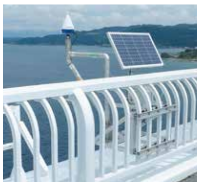
橋梁上でのGNSS設置例
