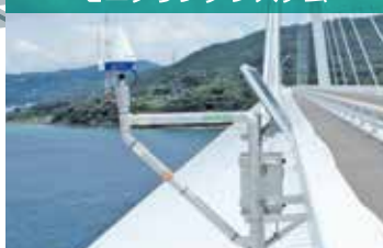
GNSS変位 モニタリングシステム
