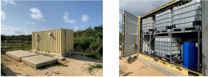
＜「まいぱり」敷地内の複合発酵設備＞
